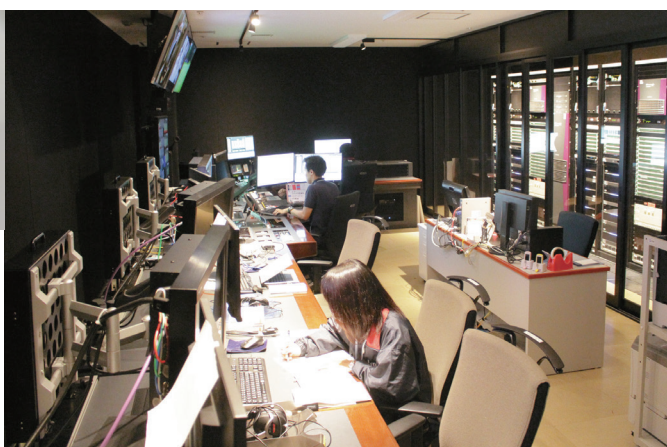
スカパー東京メディアセンターにある4K放送のマス タールーム。4Kは映像データのフォーマットが従来と 違うので、専用の機器や場所が必要なのだ。
